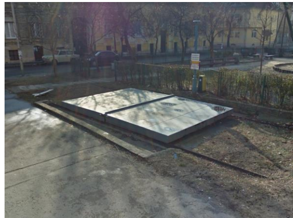
Román utcai földbe süllyesztett gáznyomásszabályzó
