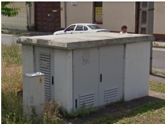
28421 sz. betonházas transzformátor a Mázsza utcában
