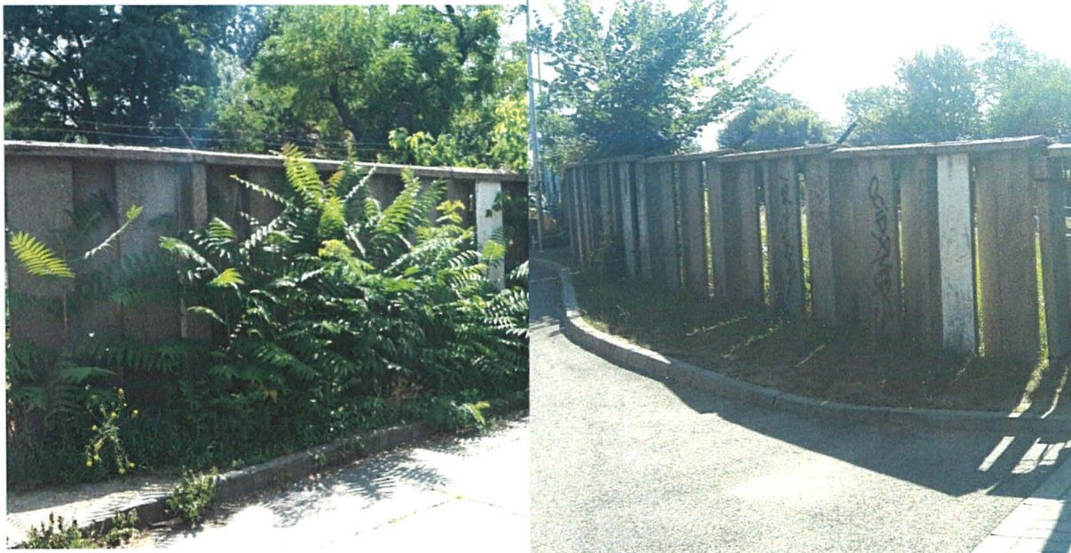
Örs vezér tere – buszvégállomáson a növénykazetták gyomosak, fasarjasak
