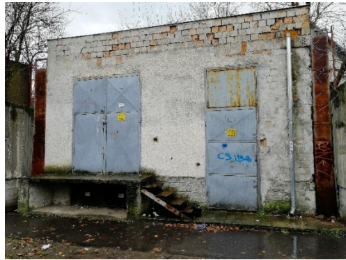
28131/10 építettházias transzformátor 10/0,4 kV-os transzformátor, Bánya utca
