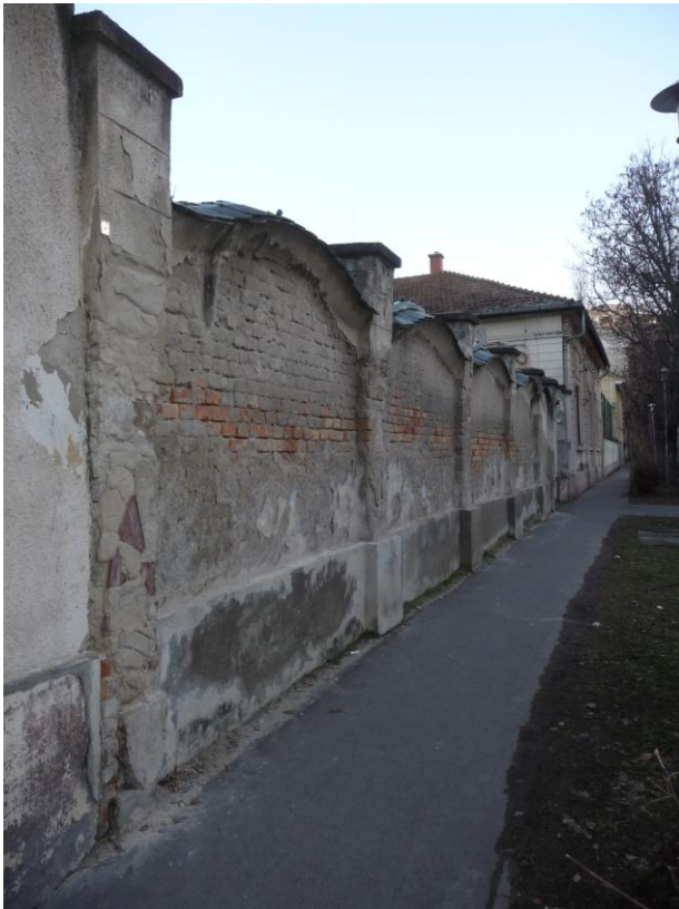
103. A kerítésfal kifelé dőlése a külső oldalon
