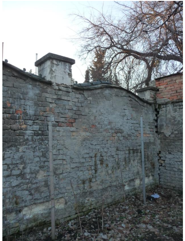
104. A kerítésfal kihúzódása a belső falsarokban
