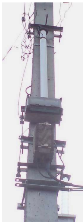
Oszlopon elhelyezett mikrocellás távközlési berendezés
