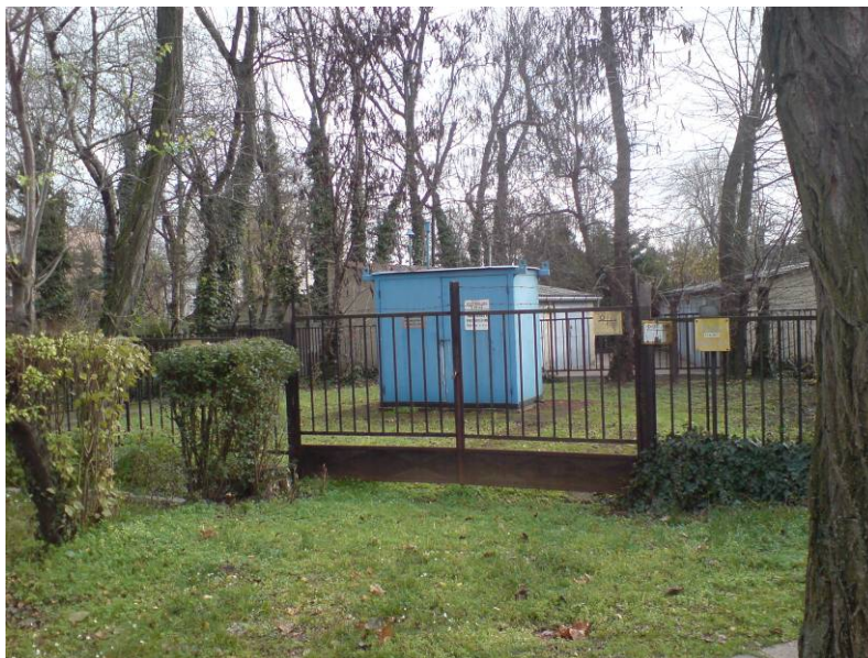
Szlávy utca és a Tarló utca kereszteződéséhez közel lévő nagy-középnomású/kisnyomású nyomásszabályzó
