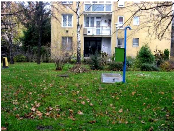
A Harmat utcai aknás nyomásszabályzó
