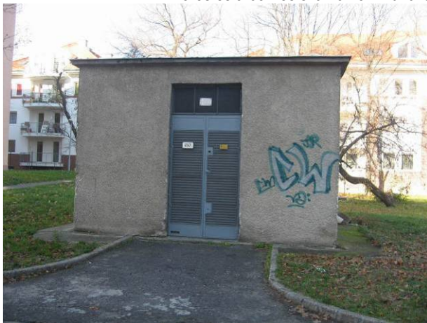
A 4147-es számú építésházás kommunális transzformátor
