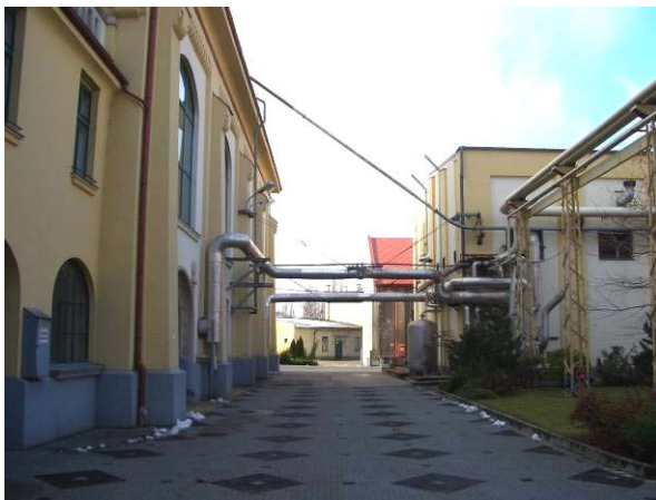
Gőzvezeték a sörgyár belső közlekedőútja felett
