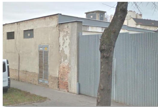
3805 sz. 10/0,4 kV-os épületben elhelyezett transzformátor
