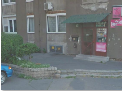
4819 sz. épületben elhelyezett 10/0,4 kV-os transzformátor
