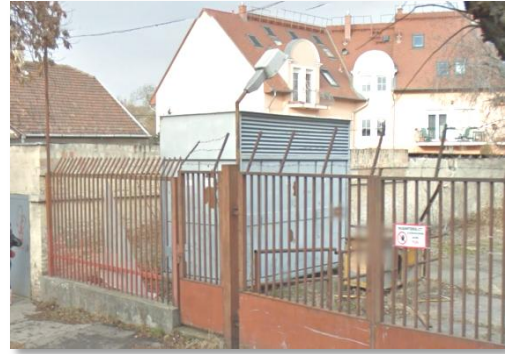
3545 sz. lemezházban 10/0,4 kV-os transzformátor
