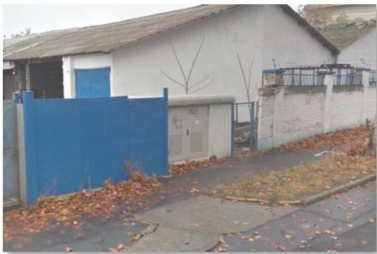
3157 sz. 10/0,4 kV-os betonházas transzformátor
