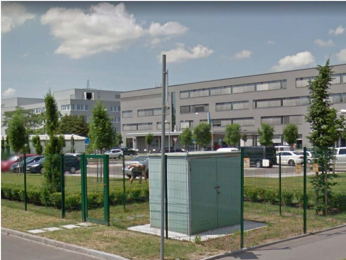
Lemezház nagyközép/kisnyomású gáznyomásszabályzó a területen
