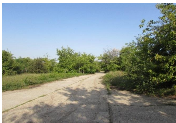
felhagyott belső burkolat
