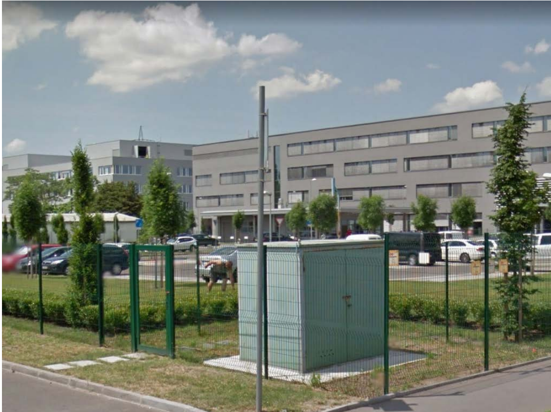
Lemezházas nagyközép/kisnyomású gáznyomásszabályzó a területen
