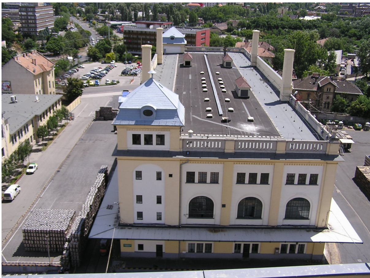
Hordófejtő épület két lépcsőházi tornyának fémlemez fedése is felújításra vár
