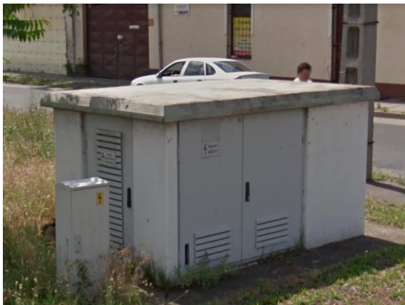
28421 sz. betonházas transzformátor a Mázsa utcában
