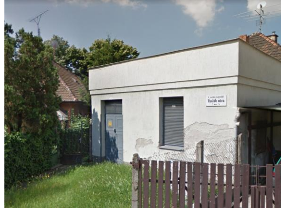
Épületben elhelyezett 10/0,4 kV-os transzformátor
