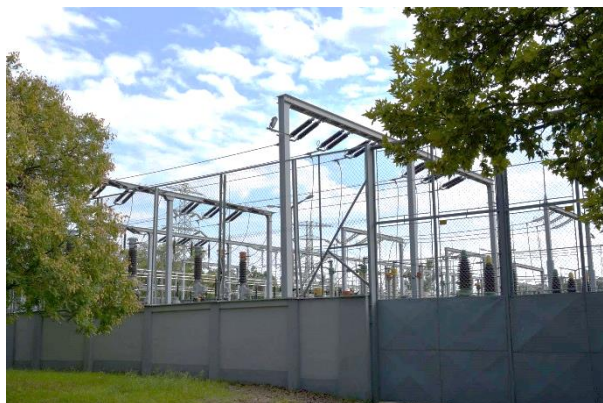
A Népligetben található elektromos alállomás
