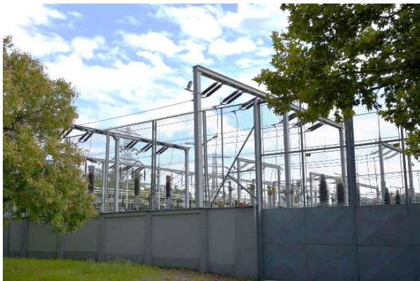
Népliget 120/10 kV alállomás
